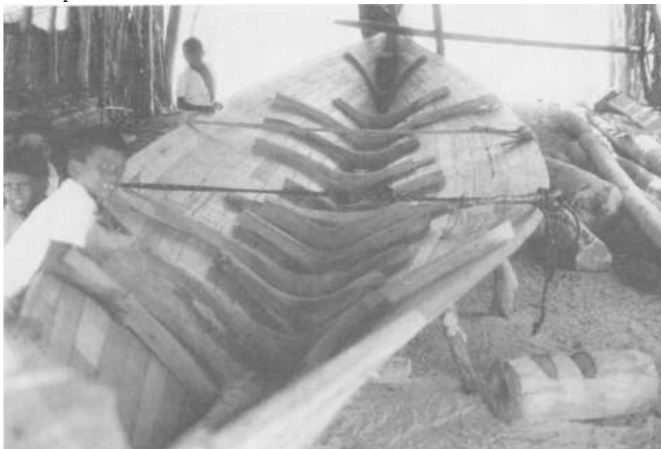
Photo 4. Phase intermédiaire de la construction de la coque : après 1 assemblage des virures du fond, les varangues ont été mises en place on remarque les cordages qui tiennent le tout en compression
